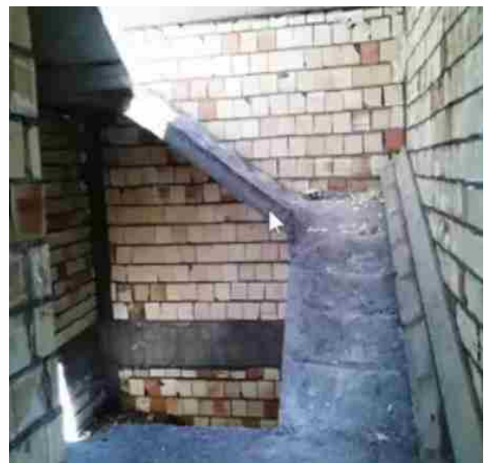
عدم استفاده از نرده حفاظتی در راه پله و احتمال سقوط
