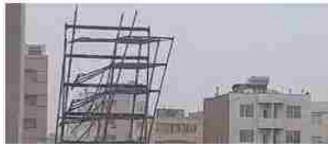
شکل ۹۰- از هم پاشیدن اسکلت فولادی در اثر وزش باد
