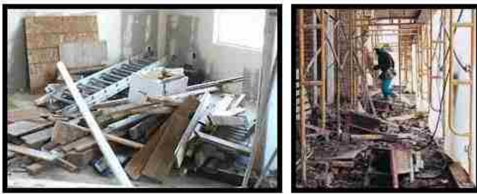
شکل ۴- کارگاه ساختمانی به هم ریخته
