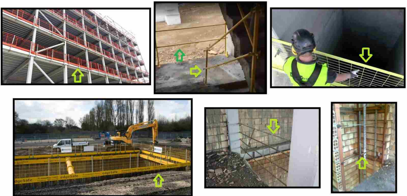
شکل ۲۵- کاربرد نرده‌هایی حفاظتی در کارگاه ساختمانی
