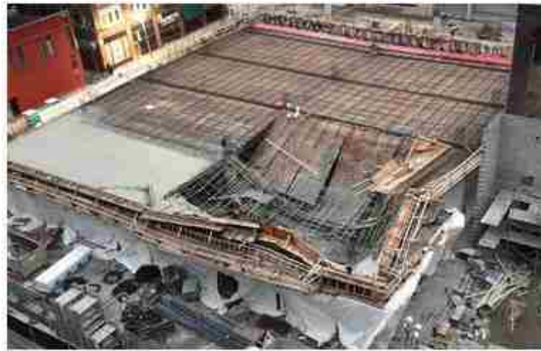
شکل ۹۳- نمونه‌ای از فرو ریختن قالب‌بندی سقف به هنگام بتن‌ریزی
