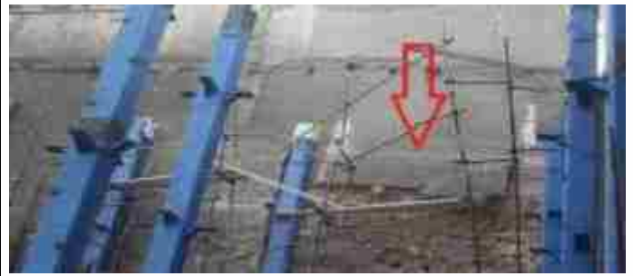
ریزش دیوار تحکیم شده و آسیب دیدن داربست و سکوی کار مقابل
