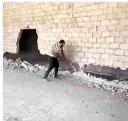
شکل ۹۹- تخریب غیراصولی دیوار
