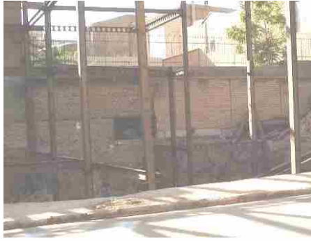
عدم حصار کشی مناسب اطراف گود - عدم نصب علائم هشدار دهنده
