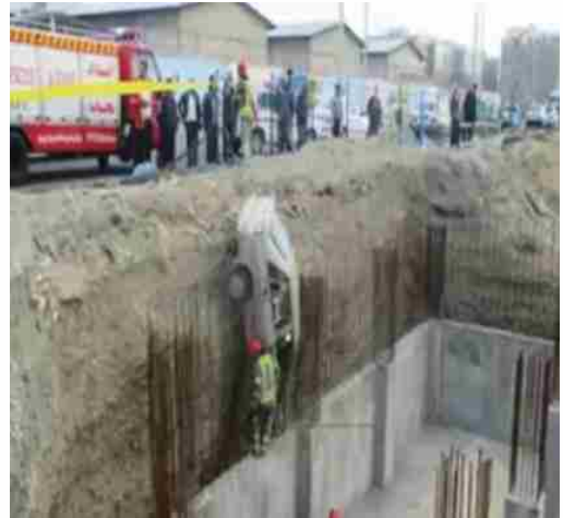
سقوط خودرو به داخل گود- عدم رعایت نکات حفاظتی اطراف گود
