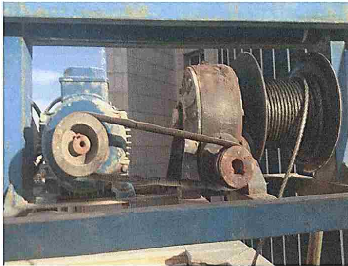
شکل ۸۶- عدم نصب قاب قسمت دوار، تسمه و پولی
