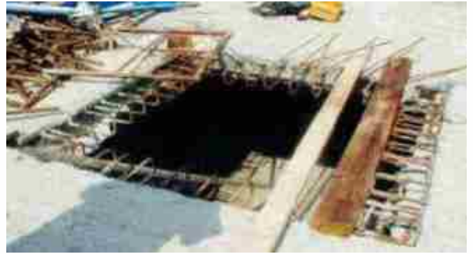
دهانه باز شو حفاظت نشده و ریشه های بیرون زده آرماتور
