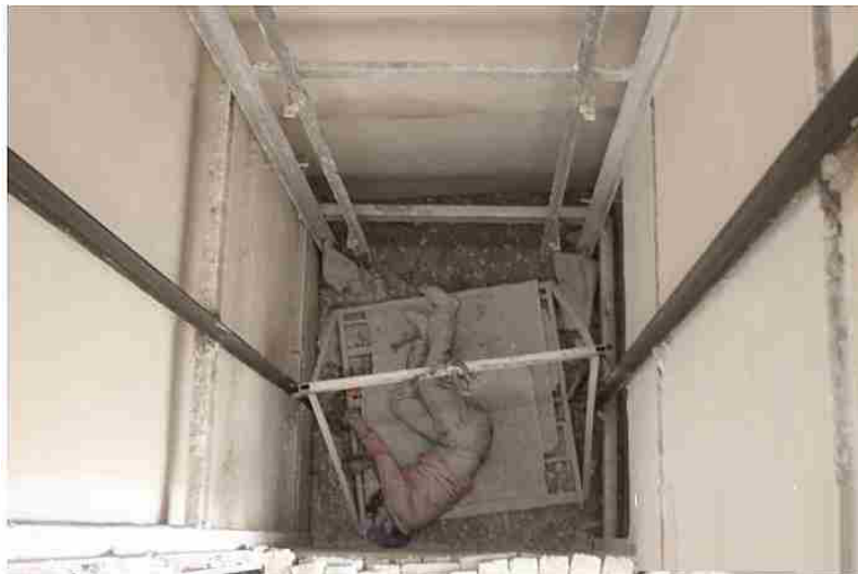
شکل ۸۳- سقوط کارگر به داخل چاه آسانسور
