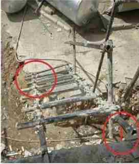
آجدار بودن پله‌های نربان فلزی - امکان لغزش پایه‌های نردبان
