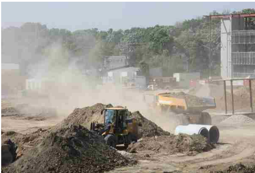
شکل ۵۲- آلودگی هوا در کارگاه ساختمانی
