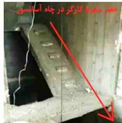
عدم استفاده از نرده حفاظتی و خطر سقوط کارگر در چاه آسانسور
